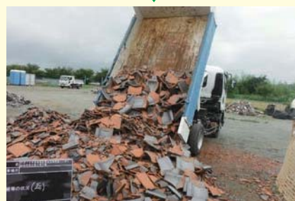
③解体工事のできた廃棄物は仮置場まで運搬され種類毎に分別され、保管しています。
