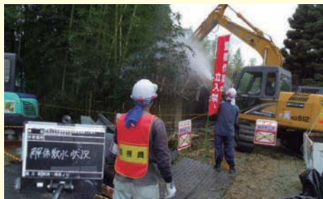
重機による家屋解体状況 作業周辺の安全確保を第一に作業しています。
